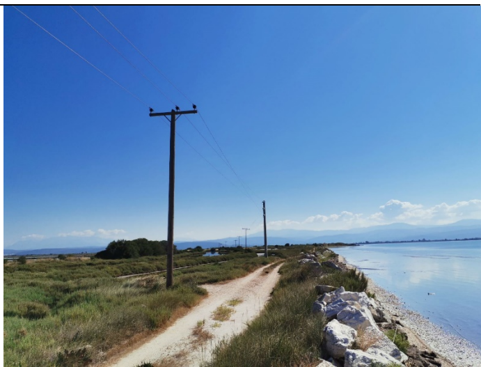
Εικόνα 3: Κολώνα με οριζόντιους μονωτήρες
